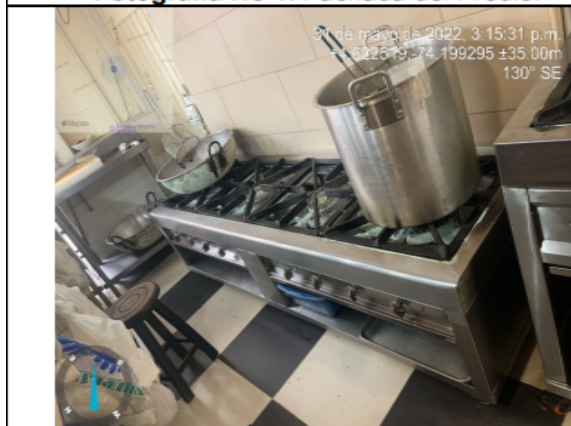
Fotografía No 3. Estufa Industrial No. 1.
