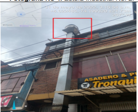
Fotografías No 8. Ducto de descarga (Horno) con extractor tipo hongo.
