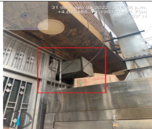
Fotografías No 6. Ducto de descarga (estufas).
