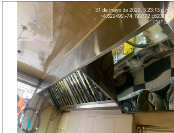
Fotografía No 5. Campana de extracción con filtros atrapa grasas.
